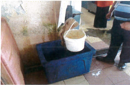
Pasar Ampangan Pili Air Rosak
