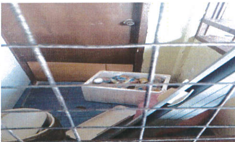
Pasar Ampangan Gerai Kosong Tidak Dibersihkan
