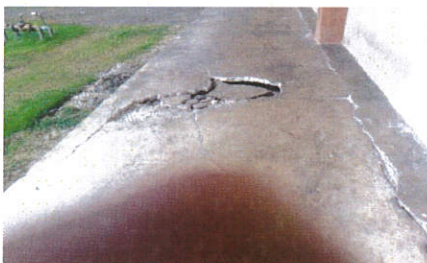
Pasar Rasah Jaya Lantai Retak
