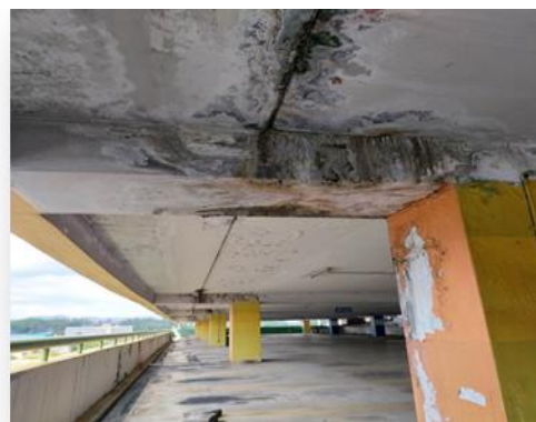
Kerosakan / kebocoran pada siling
